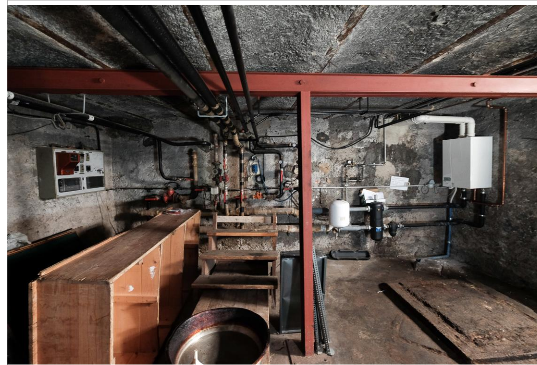
particolare degli impianti installati
